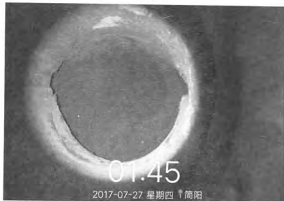
(图3c) D199旋挖成孔过程中，护筒顶下4.7m位置，褥垫层一圈坍塌
